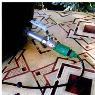
Шаровой кран с фильтром грубой очистки между сгоном и краном.
