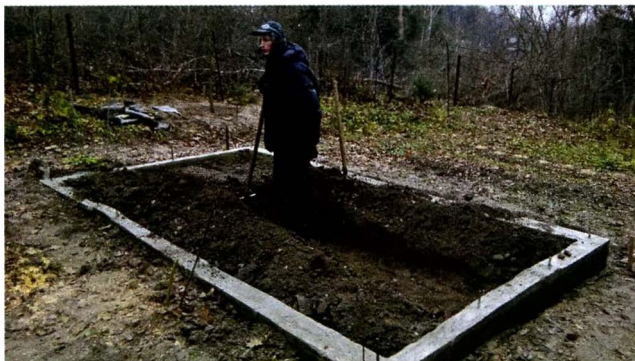
Чем шире и ровнее доски опалубки, тем красивее фундамент, но грядки всё равно копать надо.
